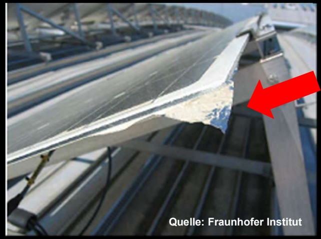
Abgelöste EVA-Folie = Korrosionsschäden
